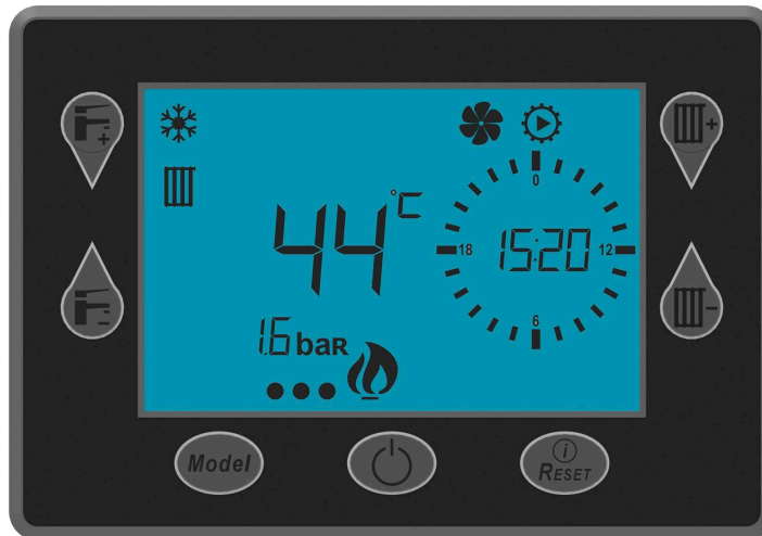
Рис. 2 Панель управления котлом
